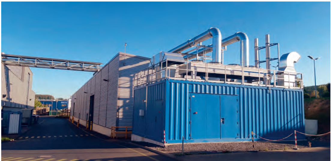
Abb. 10 Doppel-BHKW in Containeraufstellung mit Heißluftverrohrung
